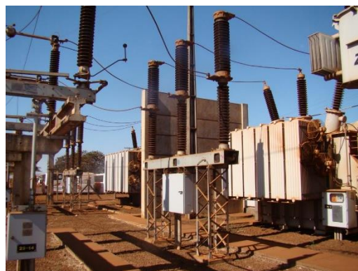
Figura 2 - Visão geral de uma Subestação de uma Usina da Guarani (Foto tirada em visita técnica à unidade)
